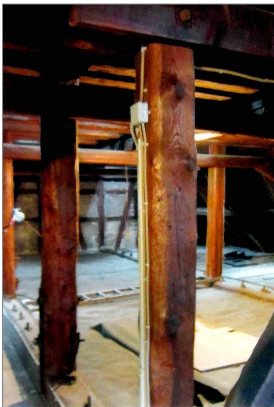
Dachbalken von 1717/1718 unterm Dach der Französisch Reformierten Kirche in Offenbach am Main Foto: Robert Flauaus
